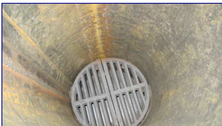
Рис. 6. Колосники чугунные, установленные в шахте котла
